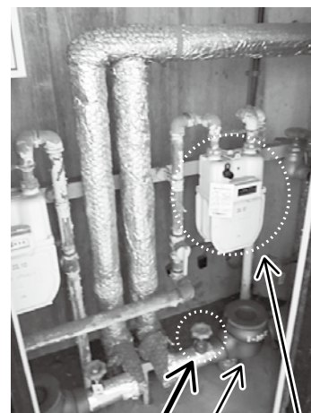
止水栓 水道メーター ガス メーター
